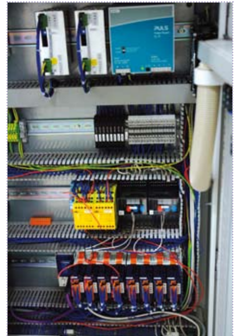
Afbeelding 3. Besturingskast met onder meer Remote I/O-stations.
