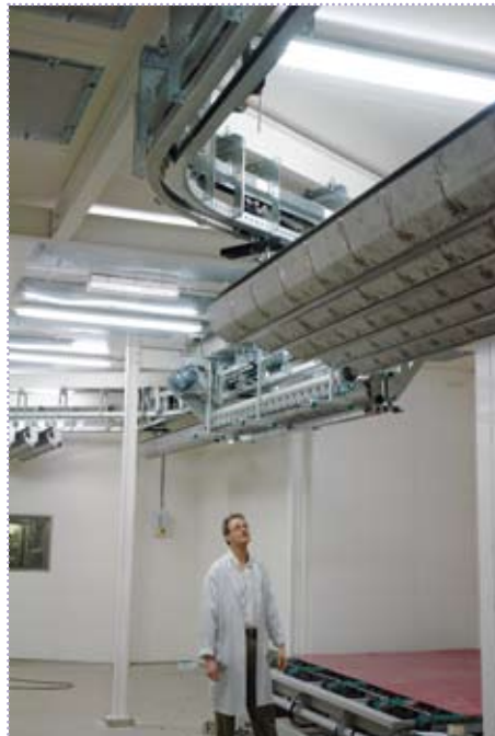
Afbeelding 2. Hans van Tilborg, technisch directeur van Eurogard SPX bij een bufferstation in de 'clean room'-ruimte. De besturing van het railsysteem wordt verzorgd door een Siemens S7 300 plc die over Ethernet met de main controller van Saia communiceert.
